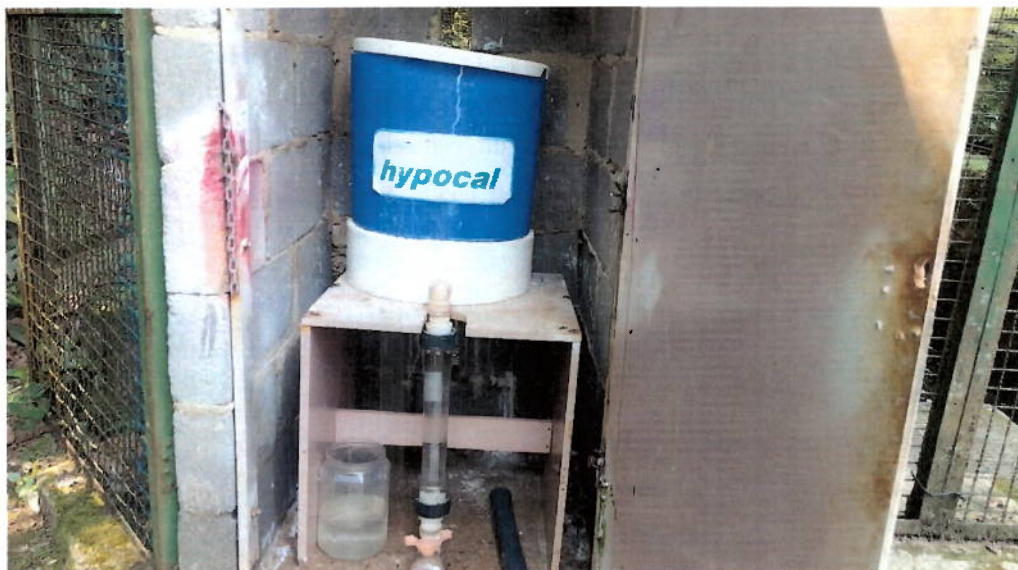
Foto 7 – sistema de cloração com hipoclorito de cálcio.
