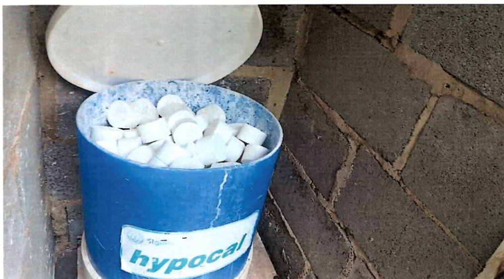
Foto 8 – sistema de cloração com hipoclorito de cálcio.
